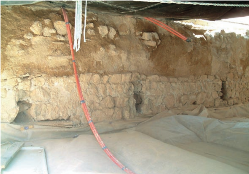
Foto 4. Consolidación de la base de la cubierta en tierra del monasterio, in correspondencia de la cubrición de los triforios.
